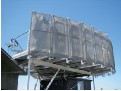
Solar station della Technische Universität München, Germania.
