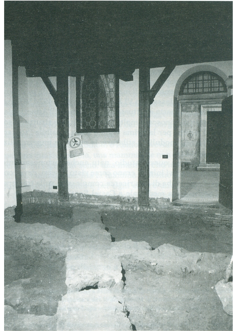
Castel Sant'Angelo, Armeria, stanza n. 1, a destra uscendo dalla rampa diametrale. Rinvenimento di muri intersecati trasversalmente da una condotta d'acqua con pendenza verso il cortile (ottobre 1993).
