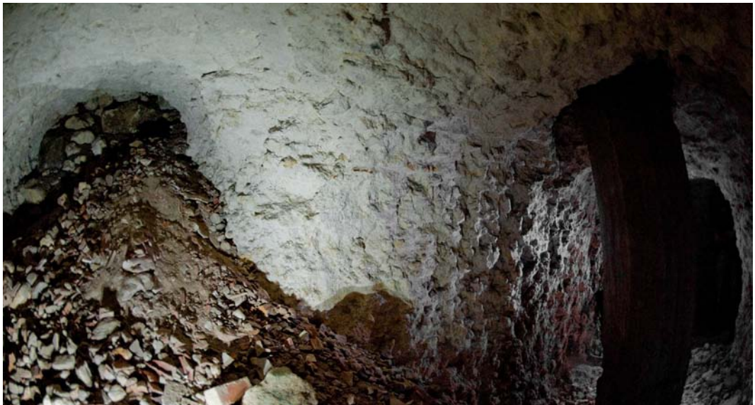
GALLERIA-RIFUGIO ESSANN: ZONA DI FRANA
