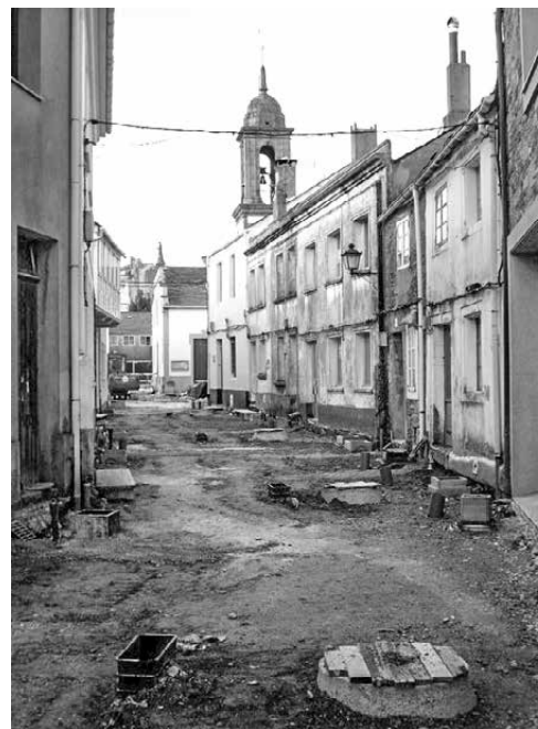
A rúa da Igrexa en obras sen autorización da Dirección Xeral do Patrimonio Cultural
