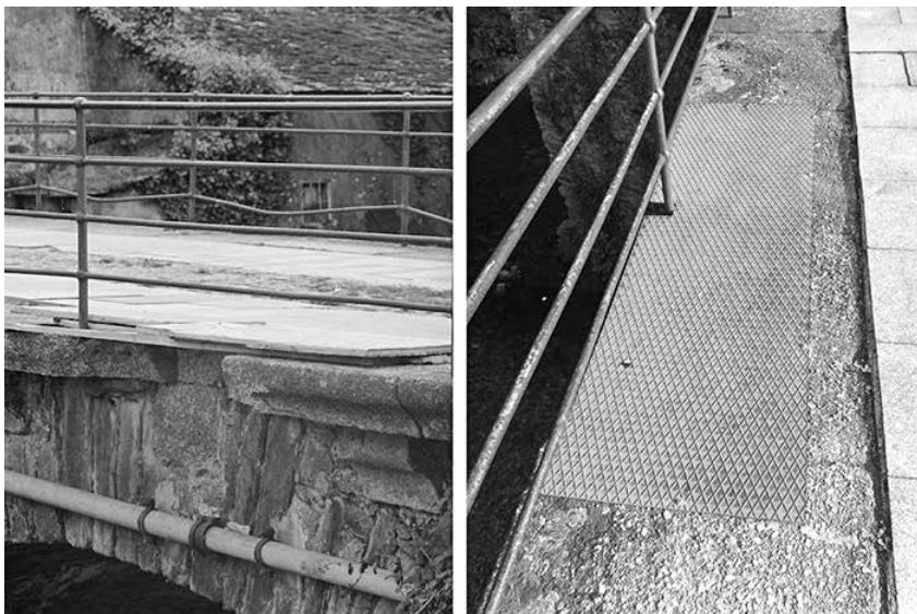
Esquerda, cornixa da ponte danada no transcurso das obras da Rúa da Igrexa.
