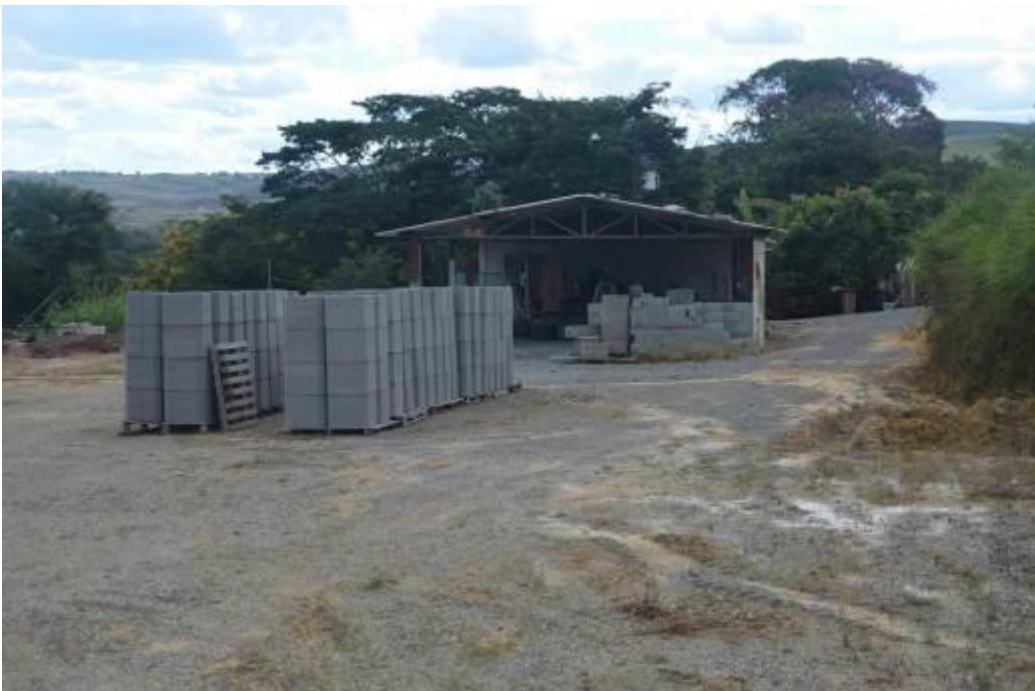
Foto 37. Galpão de produção de artefatos e pré-moldados de cimento, na mesma propriedade da casa das palmeiras.
