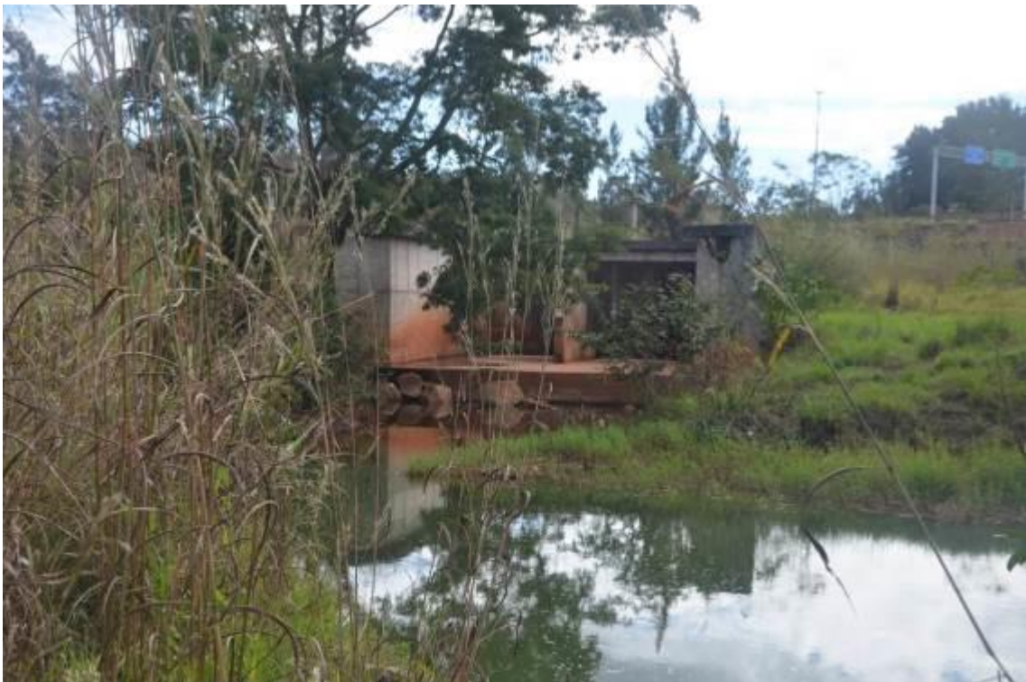
Foto 3. Dissipador de energia para lançamento de águas pluviais no balneário do Rio Descoberto, caracterizado como uma das fontes de contaminação do curso d'água. Foto: Pedro Braga Netto.
