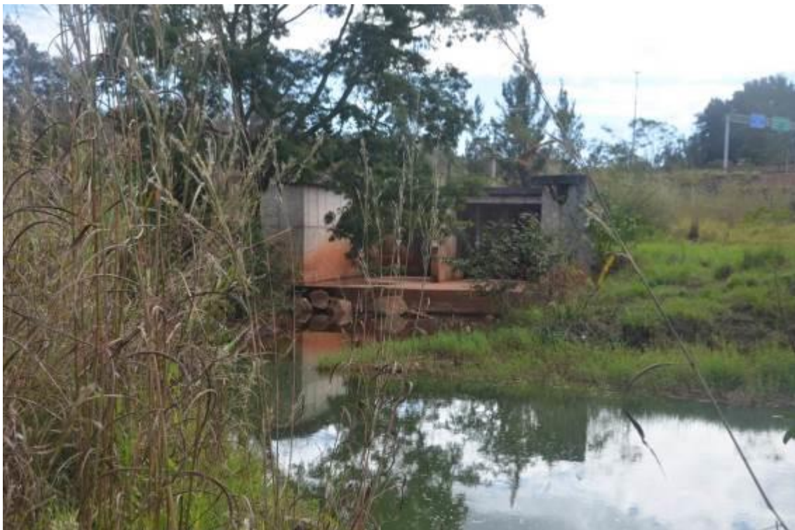
Foto 4. Dissipador de energia no lançamento de rede de águas pluviais no rio Descoberto.
