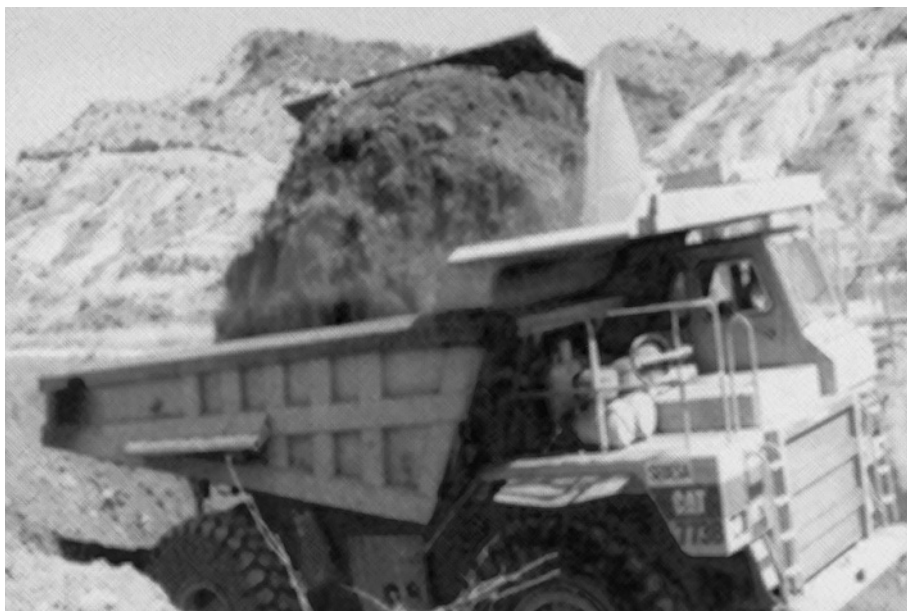
Fot. 2. Retirada del material vegetal para su uso posterior en plataformas y taludes.
