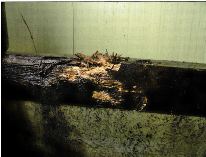
Bild 1: Weißfäuleschaden an einem Querbalken aus Bongossi
