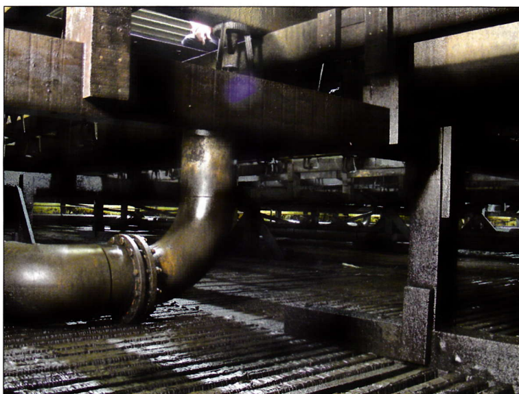
Bild 3: Verrieselungsgerüst außer Funktion; Blick unter das Wasserverteilungssystem; die Holzoberfläche war mit einer schwarzen Schmutzschicht überzogen.
