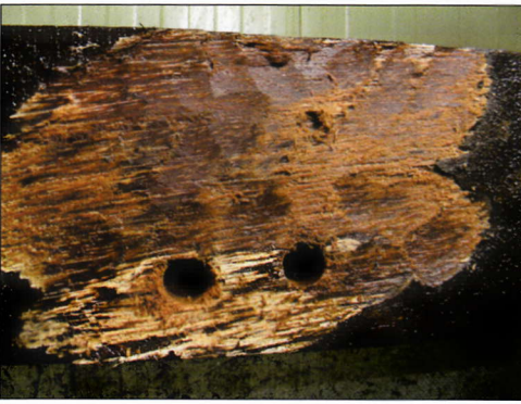
Bild 11: Weißfäuleschaden: An diesem Träger wurden einige Millimeter der Holzoberfläche abgetragen.
