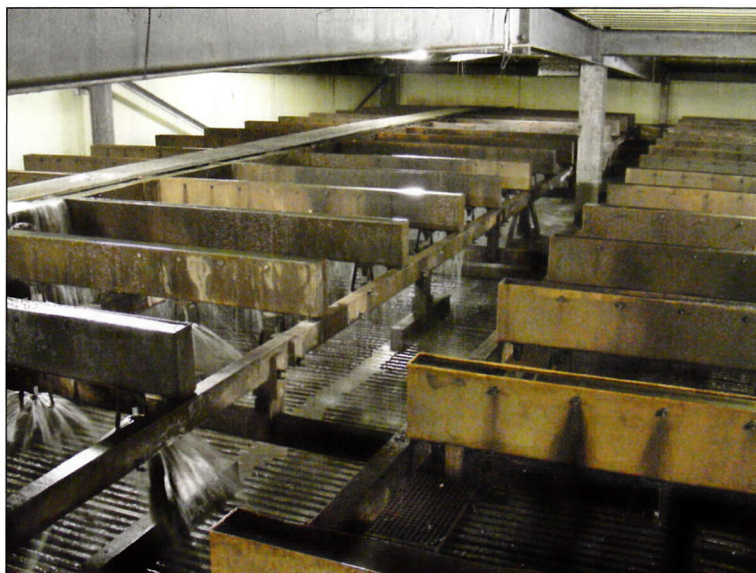
Bild 2: Verrieselungsgerüst in Funktion; ein Großteil der Konstruktion war ständig befeuchtet.
