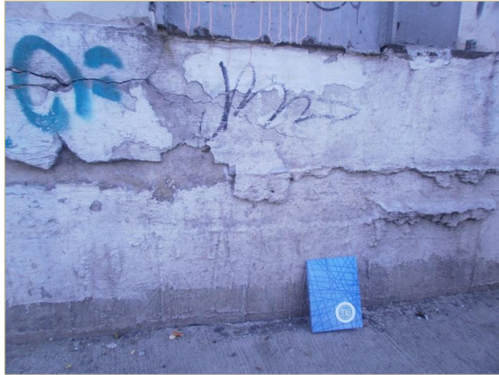
Figura 5.8.1.6. Se observa tres niveles de subsidencia al que se ha sometido el inmueble, el primero de 34 cm, el segundo de 12 cm y el tercero de 24 cm.
