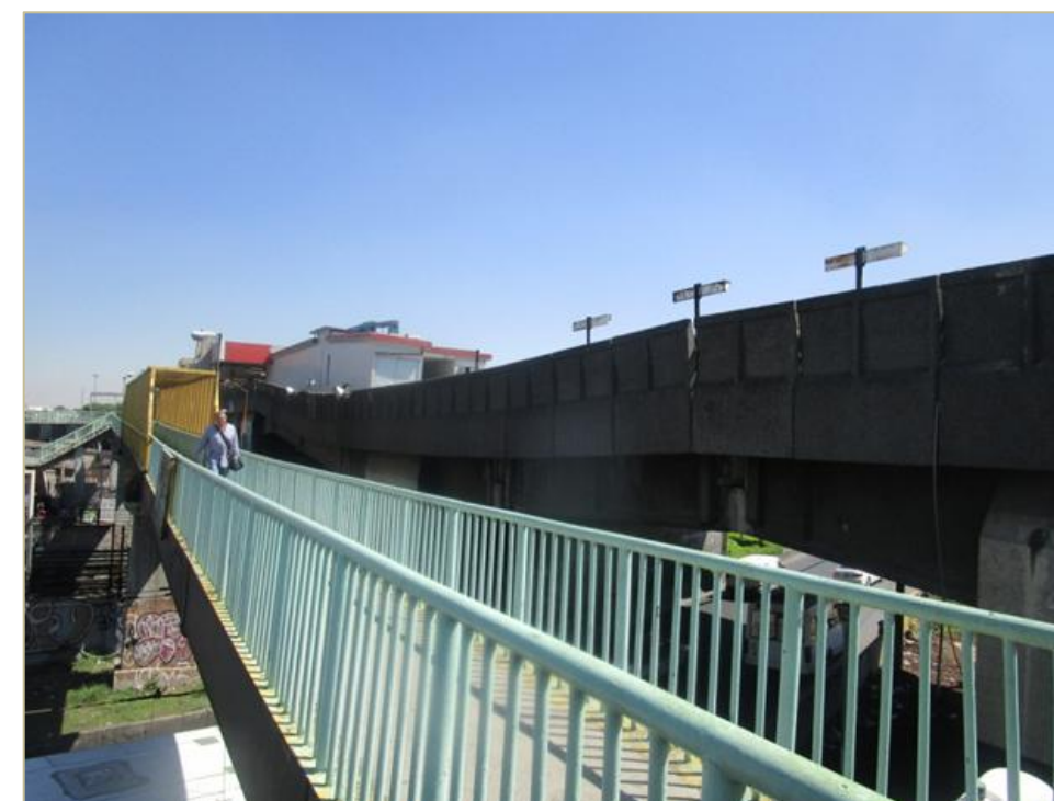
Figura 5.1.7.3 Flexión del cajón del Metro línea nueve debido a un hundimiento diferencial, sobre Avenida Pantitlán y Canal Churubusco
