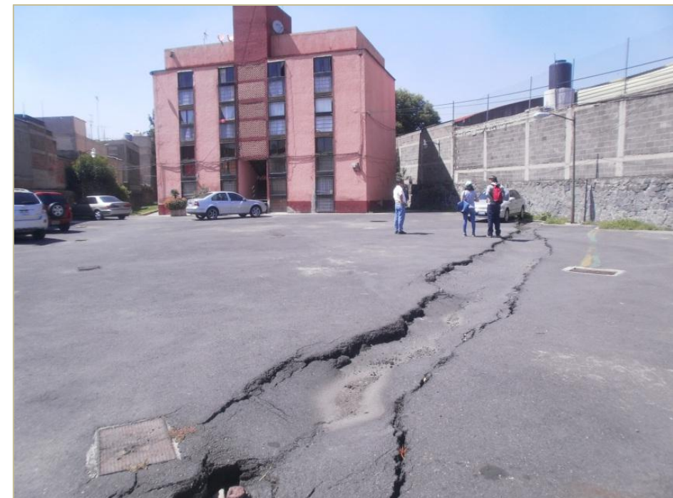
Figura 5.1.9.1. Agrietamiento en la Alcaldía Iztacalco.
