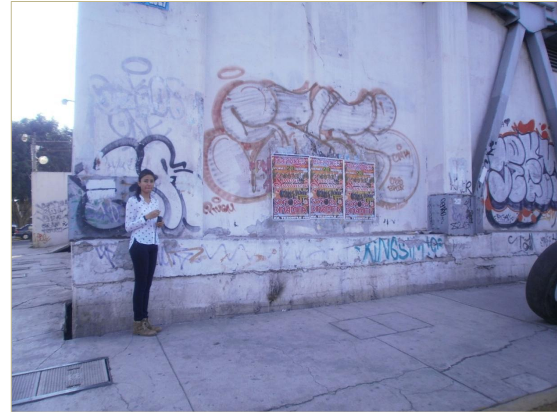
Figura 5.8.1.7. Nivel de la subsidencia con respecto al edificio de Telmex en la colonia INFONAVIT Iztacalco, corresponde a 70 cm.
