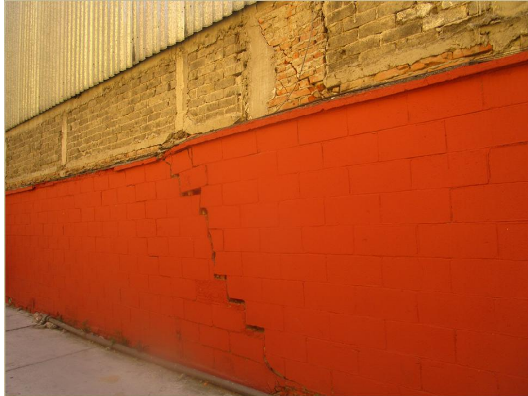
Figura 5.1.9.7. Agrietamiento E-W de la U.H. La Concordia, afectando a muros perimetrales y pérdida de verticalidad entre las torres.
