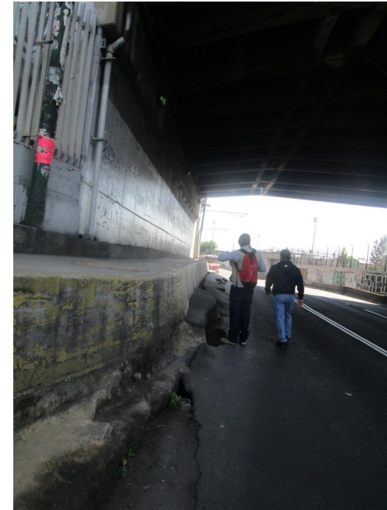
Figura 5.1.9.6. Agrietamiento NW-SE con un salto de 40 centímetros, afectando a la vialidad de Avenida Pantitlán.
