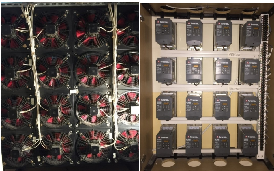
Rys. 21 Wentylatory w tunelu aerodynamicznym oraz odpowiadający każdemu z nich panel sterujący
