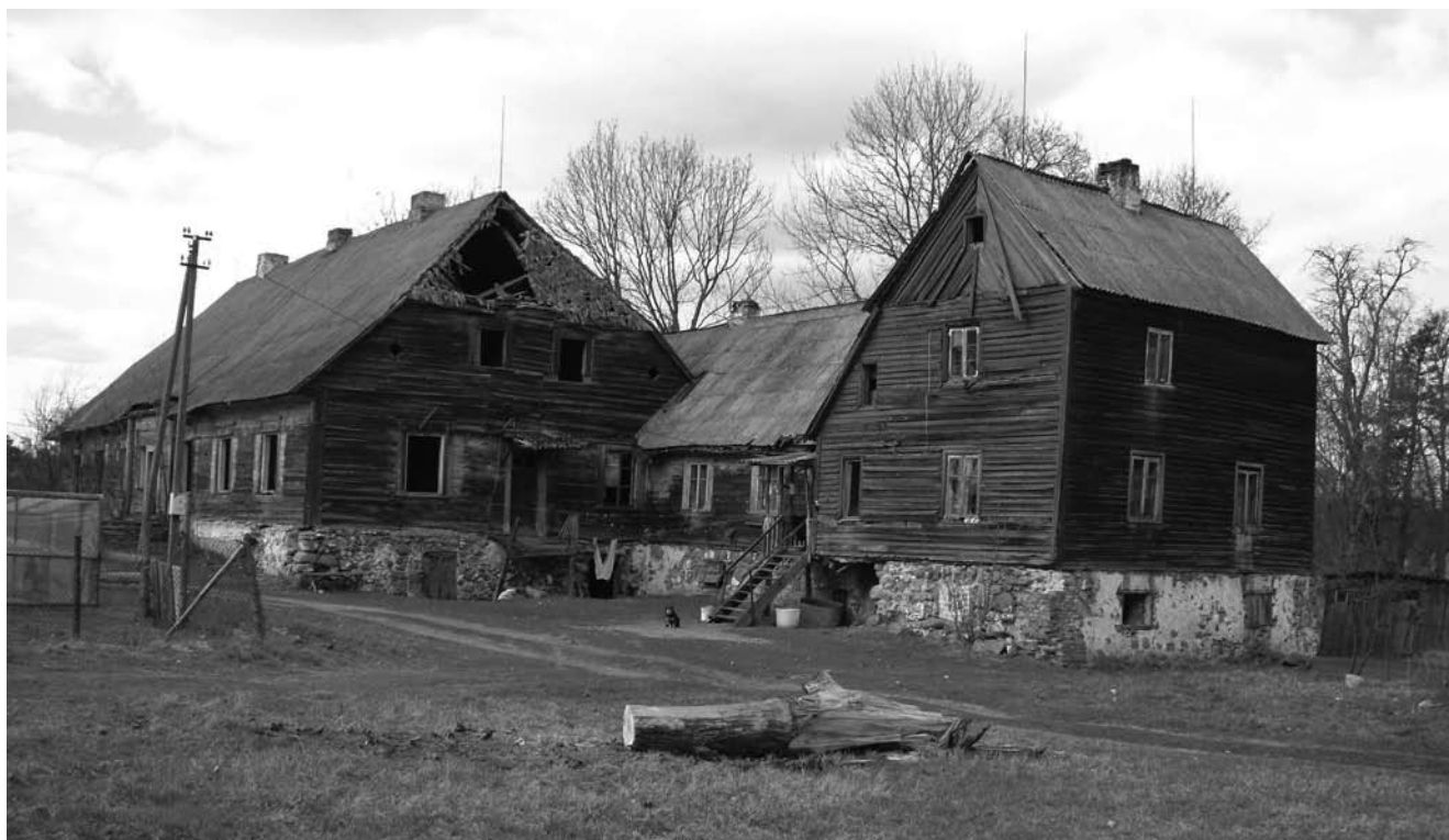
Pavilkijo dvaro sodybos archajiški mediniai rūmai Šakių rajone. Šis apleistas romantiškas dvaras Nemuno slėnyje gali greit išnykti.
