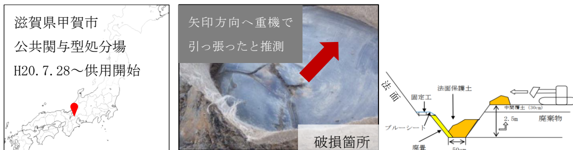
図 2.5.16 滋賀県・クリーンセンター滋賀における遮水シートの事故事例
