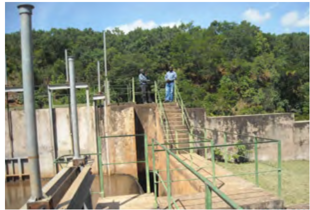
Centrale de Ngandwe Fwamba : barrage, 2011.
