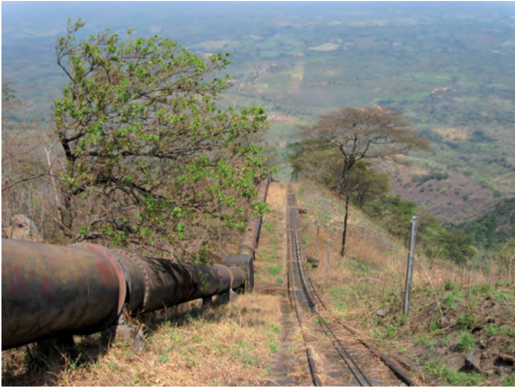
Conduite forcée à Bendera. (Photo © Benoit Fortin, 2009.)
