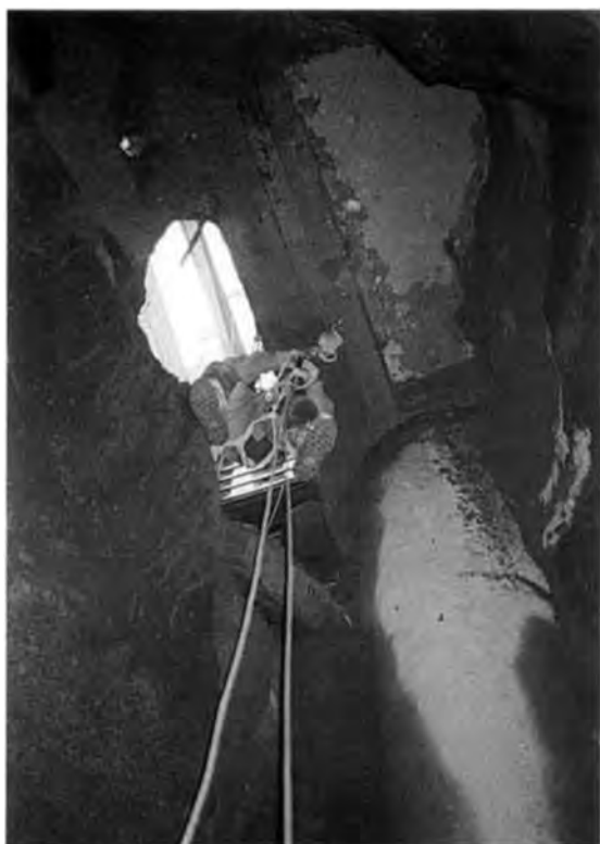
Foto 1 - Una fase della discesa nella cavità attraverso la voragine. Si notano un palo di fondazione (a) ed un masso in equilibrio precario (b) (foto B. Bocchino).
