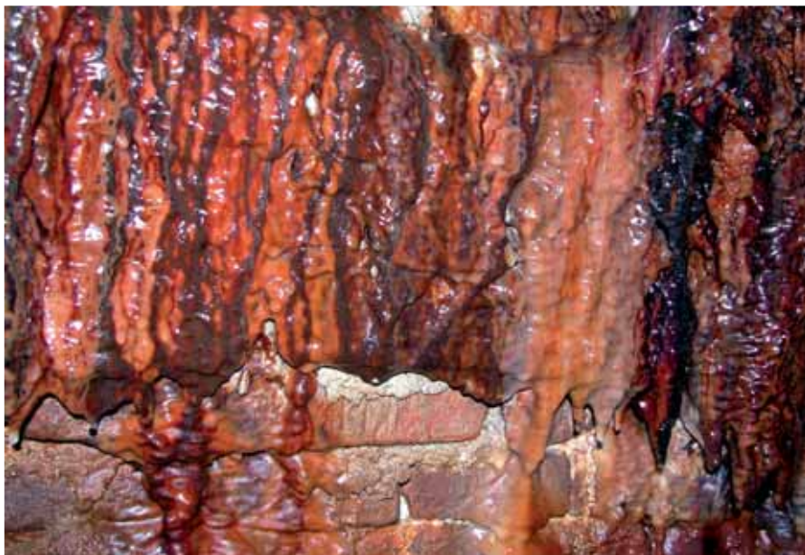
Figura 4 – Visione generale del concrezionamento sviluppatosi al di sopra di un muro di tamponamento costruito durante i lavori di riadattamento funzionale dell'acquedotto terminati nel 1881: al centro in basso sono evidenti i mattoni utilizzati nel 1880.
