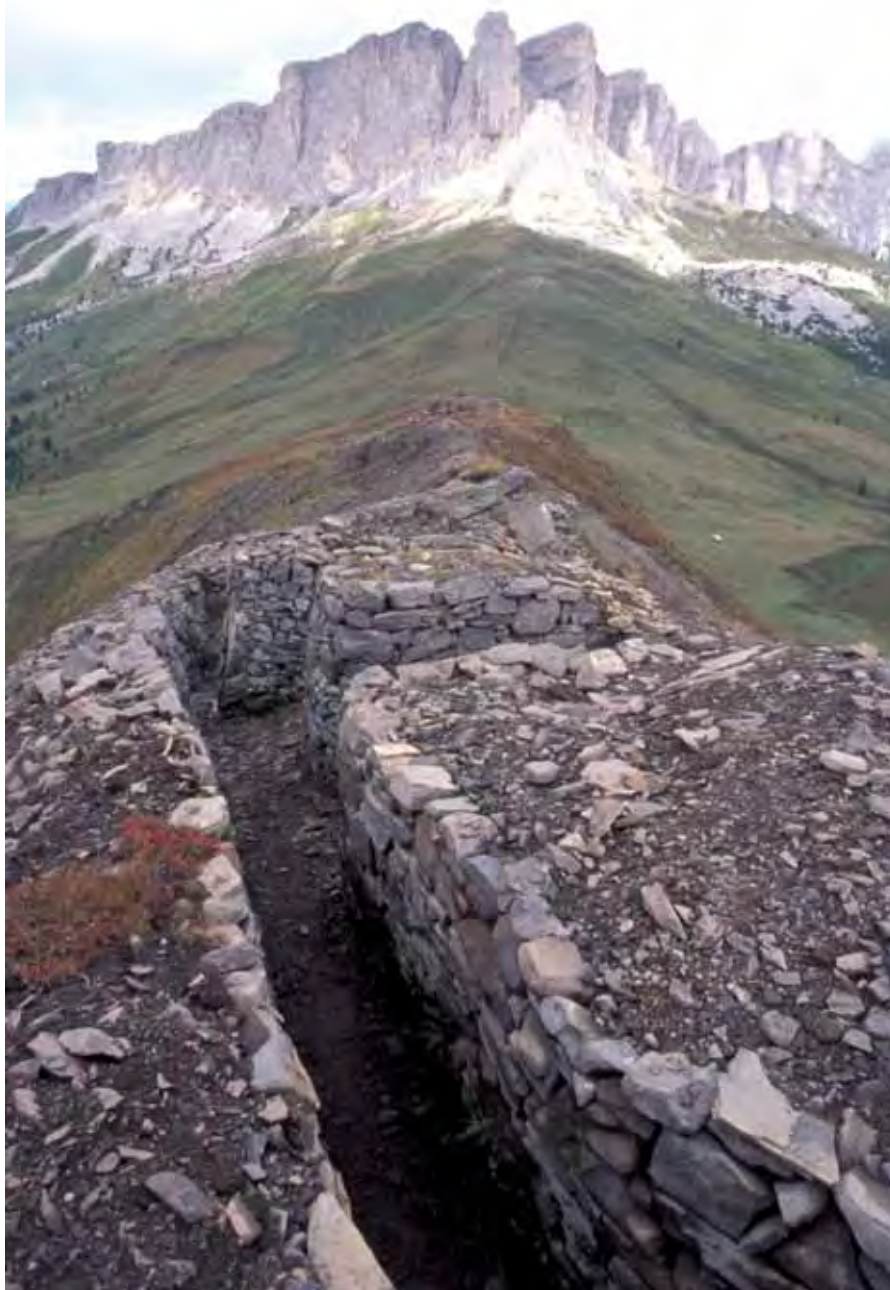
Figura 1 – Una trincea verso la sella del Sief, ripristinata nel corso dei lavori del progetto Interreg III.
