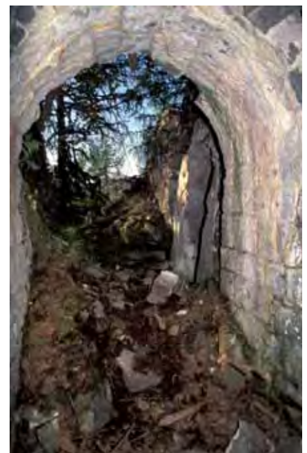
Figura 13 - CA 265 V BL - Ingresso rinforzato in cemento.
