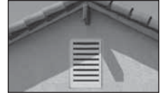
Ventilación de hastial
