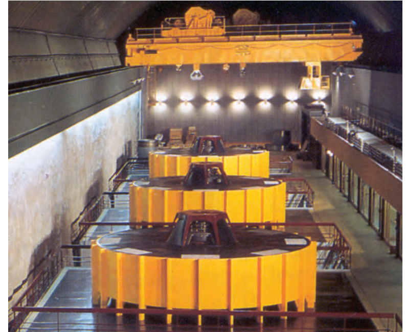
Caverne principale (115 m de long) et ses quatre groupes hydroélectriques réversibles de 200 mégawatts chacun (STEP de Saint-Nicolas-les-Mazures)
