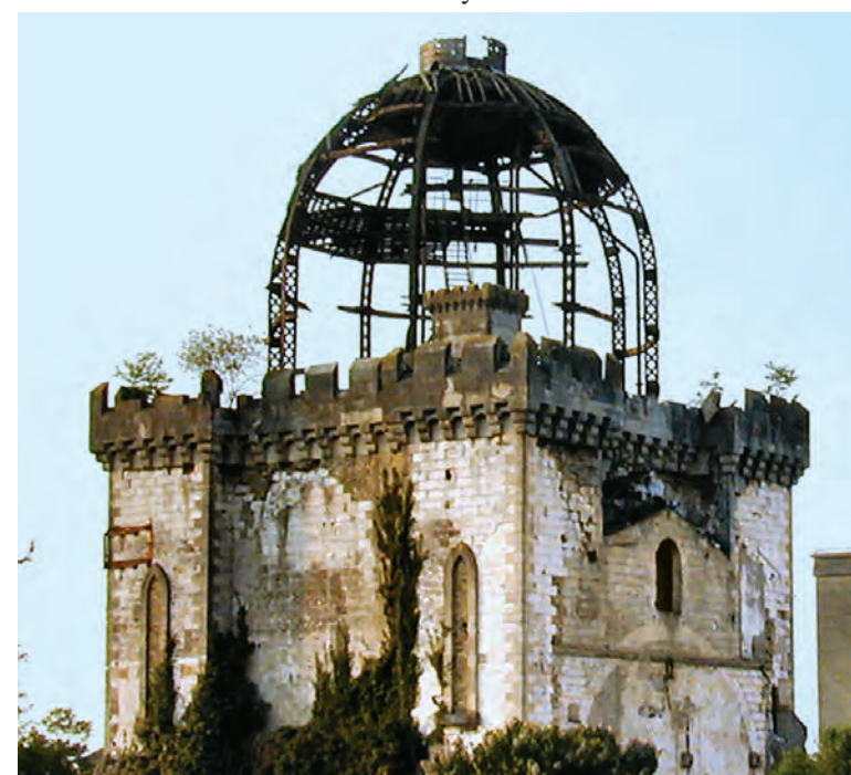
État actuel de la tour de La Comète (cliché J.-M. Duquénois)
