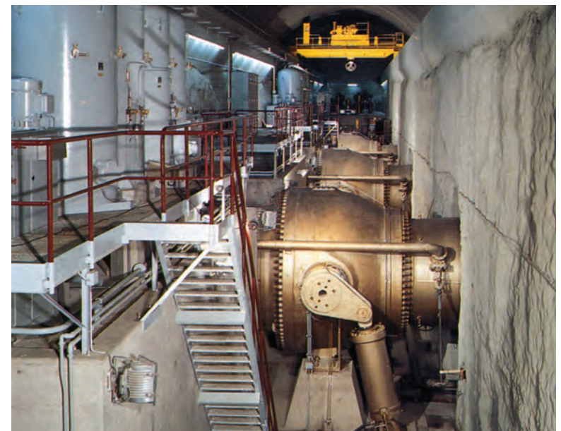
Caverne auxiliaire abritant les robinets sphériques des quatre groupes hydroélectriques (STEP de Saint-Nicolas-les-Mazures)
