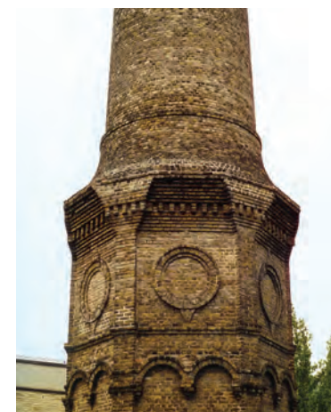
La cheminée des anciennes usines Néouze, aujourd'hui Régates rémoises (cliché D. McKee)
