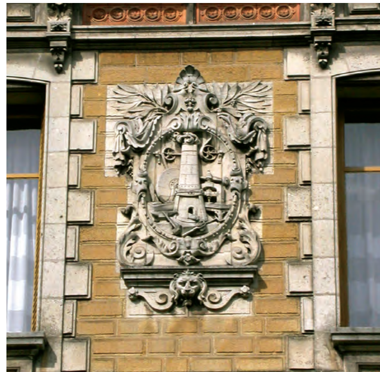
Un bas-relief sur la façade rend hommage aux outils des barons du fer (cliché S. d'Ottavio et C. Bazelaire)
