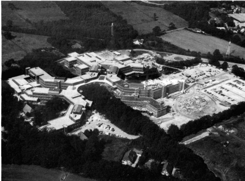
15. August 1983: Maurergerüste stehen nur noch an den Trakten der Mathematik und Physik. Die Umgebung gibt jedoch noch das Bild einer Großbaustelle wider. Foto: Wöltje (freigegeben von der Bezirksregierung Weser-Ems am 5.9.83, Nr. 39/37/1)
