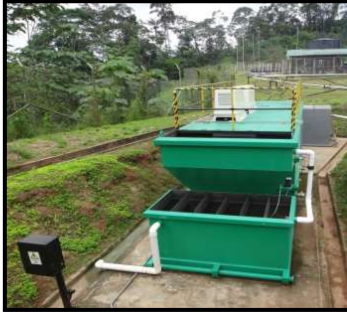
Foto 1. Sistema de Tratamiento de Aguas Negras y Grises.
