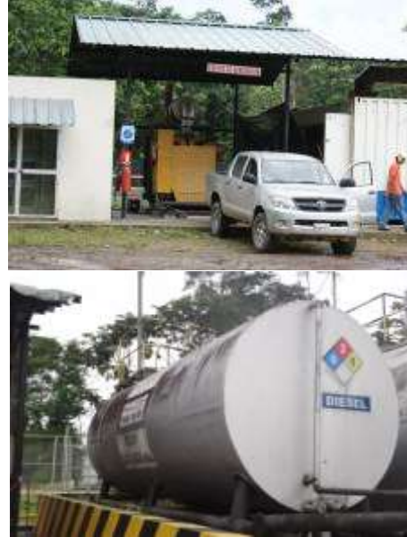
Área de generadores - Tanques de diésel
