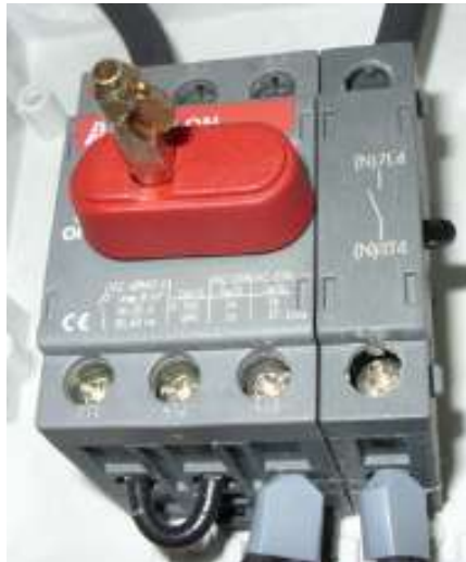
Bild 3-26: Geprüfter DC Hauptschalter mit Kontakt -Wippe
