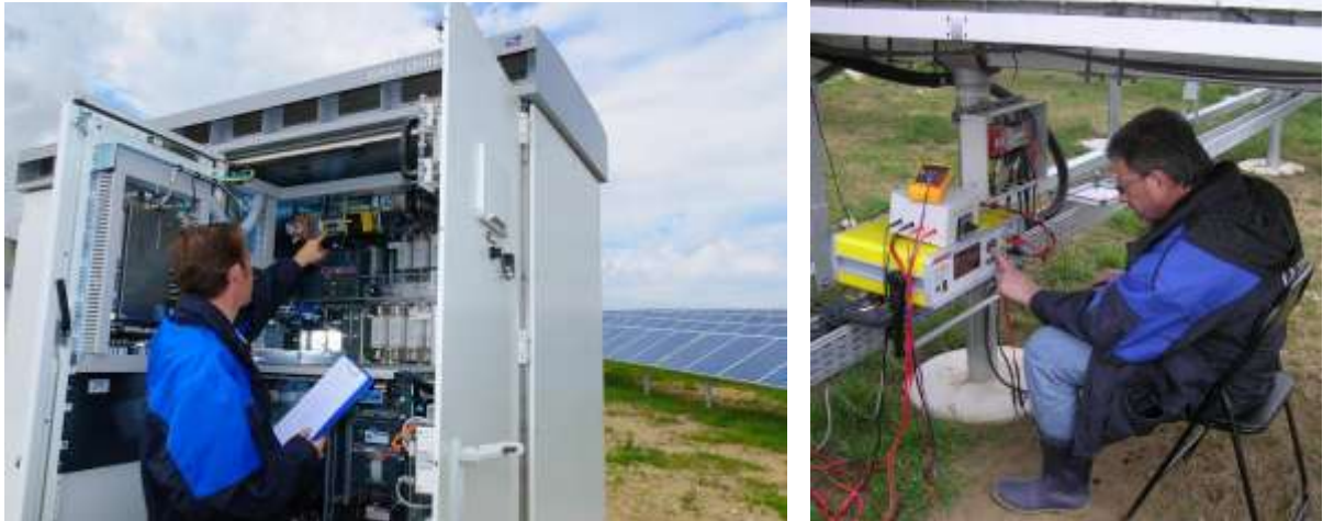
Bild 5-34: Sichtprüfung (links am WR) und Messung (rechts am GAK) im Rahmen der Abnahme
