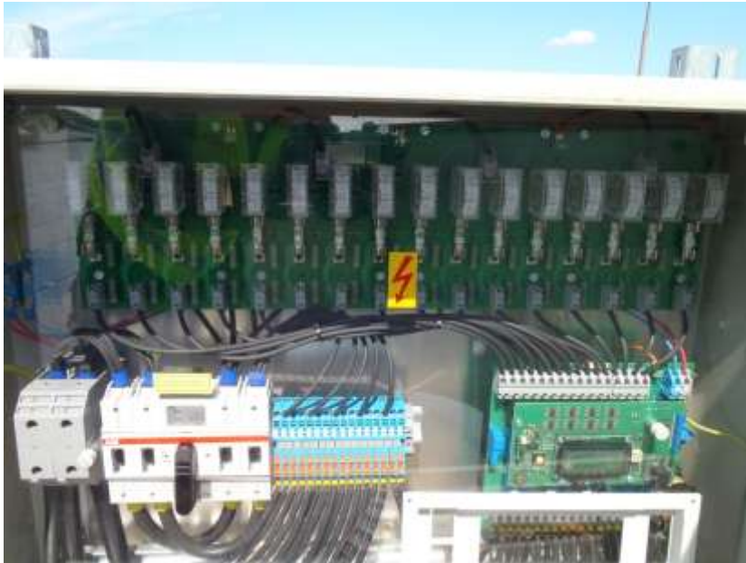
Bild 5-37: Generatoranschlusskasten mit Lastschalter und Trennklemmen
