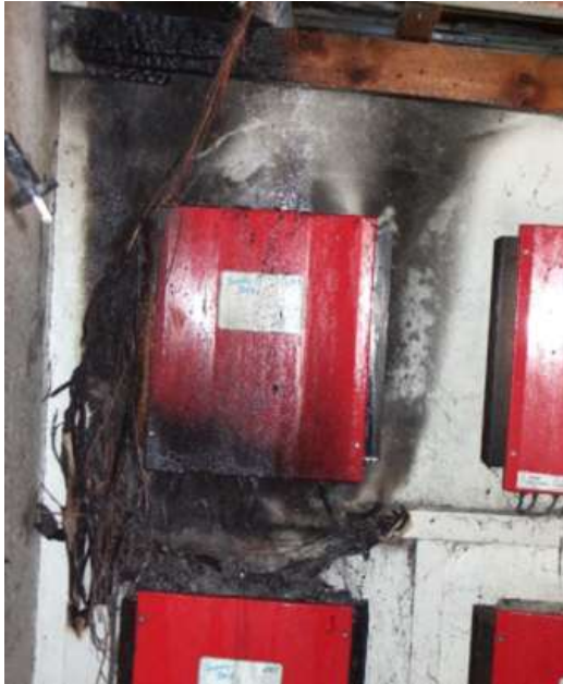
Bild 3-31: Verbrannte Leitungen an einem Wechselrichter (Quelle: Feuerwehr Weyerbusch)
