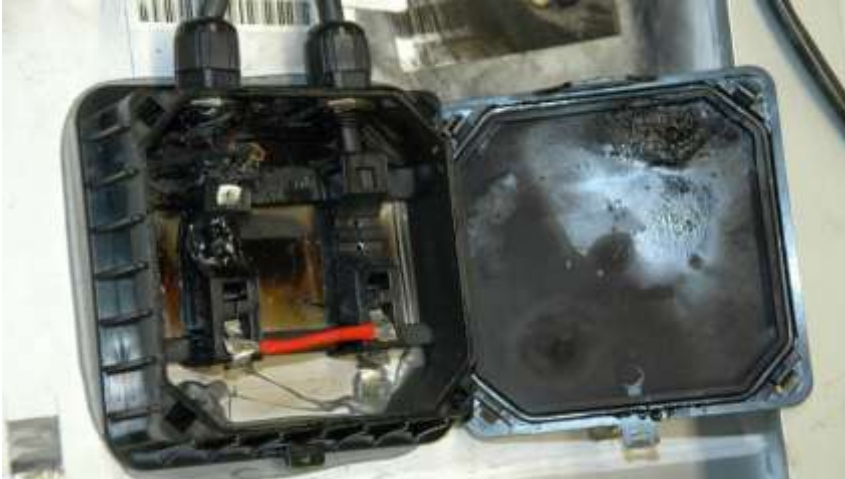
Bild 3-43: Anschlussdose nach Lichtbogen zwischen Anschlussleitung und Anschlussklemme [5]
