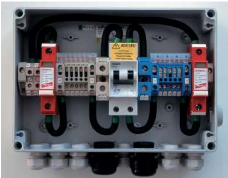
Bild 3-51: Generatoranschlusskasten [Quelle: DGS-Berlin]
