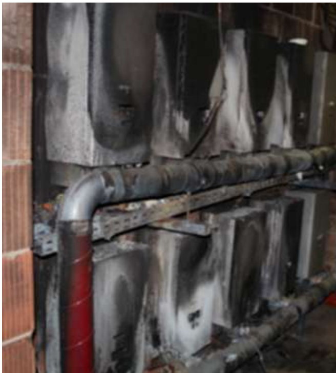
Bild 3-23: Technikraum einer PV Anlage nach einem Brand
