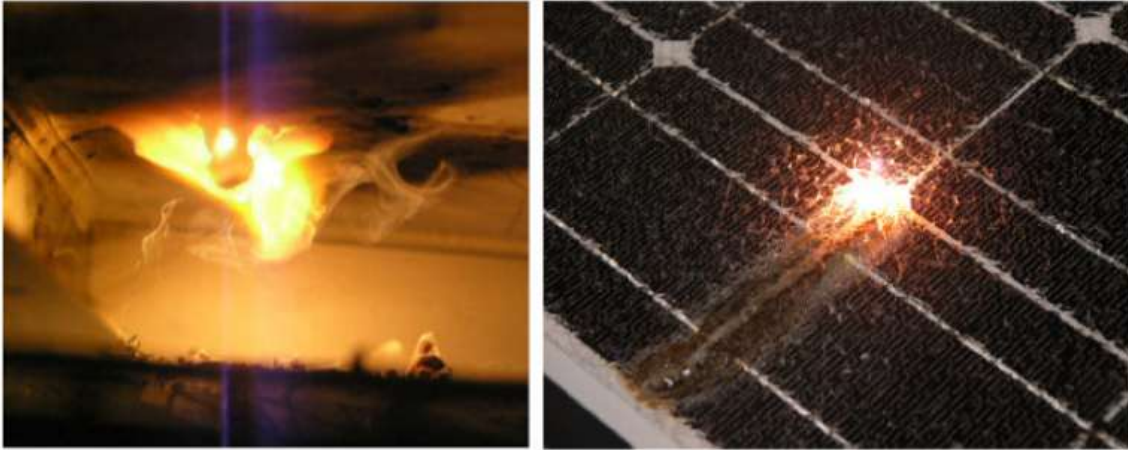
Bild 3-42: Auswirkungen eines provozierten Lichtbogens durch Durchtrennen der Zellverbinder, Fotos: TÜV Rheinland
