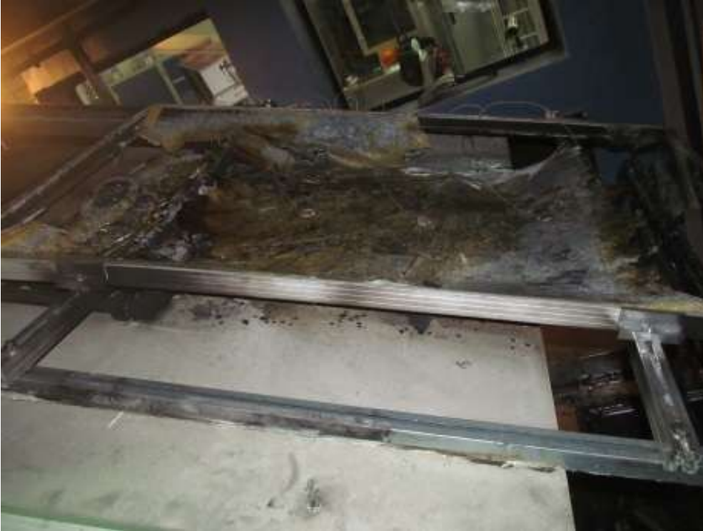
Bild 4-38: Brandrückstände von 2 CIGS-Modulen: AL-Rahmen, geschmolzenes Glas, verbackene Kunststoffreste, Ruß und Asche
