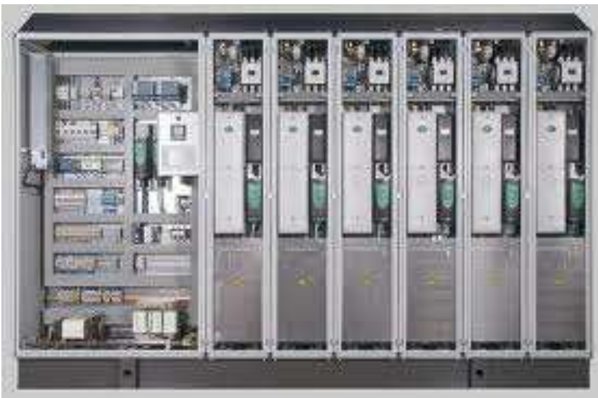
Bild 3-55: Beispiel eines Zentralwechselrichters in einem Schaltschrank
