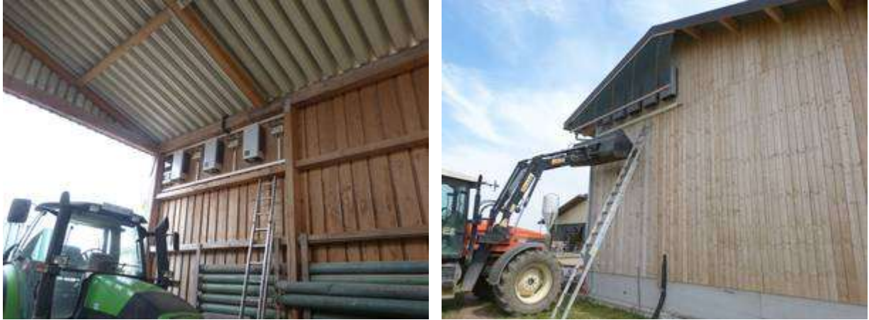
Bild 3-14: Nicht brandschutzgerechte Installation von Wechselrichtern auf Holz, zudem schwer erreichbar für die Wartung, Fotos: W. Schröder, PV-Sachverständiger, 2014
