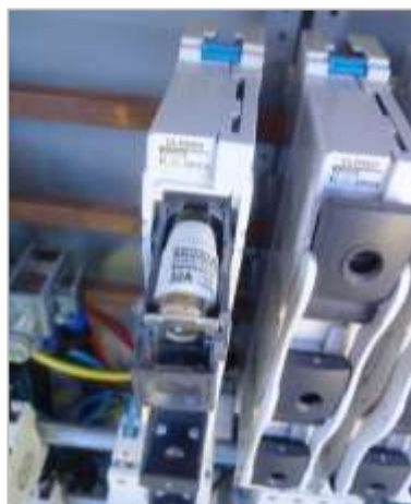
Bild 5-39: Trenner mit Sicherung
