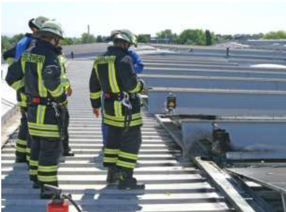
Bild 3-22: Brand eines Generatoranschlusskastens. In der Bildmitte sieht man einen baugleichen Kasten. Er besitzt kein Schutzdach. (Quelle: Freiwillige Feuerwehr Bühl)
