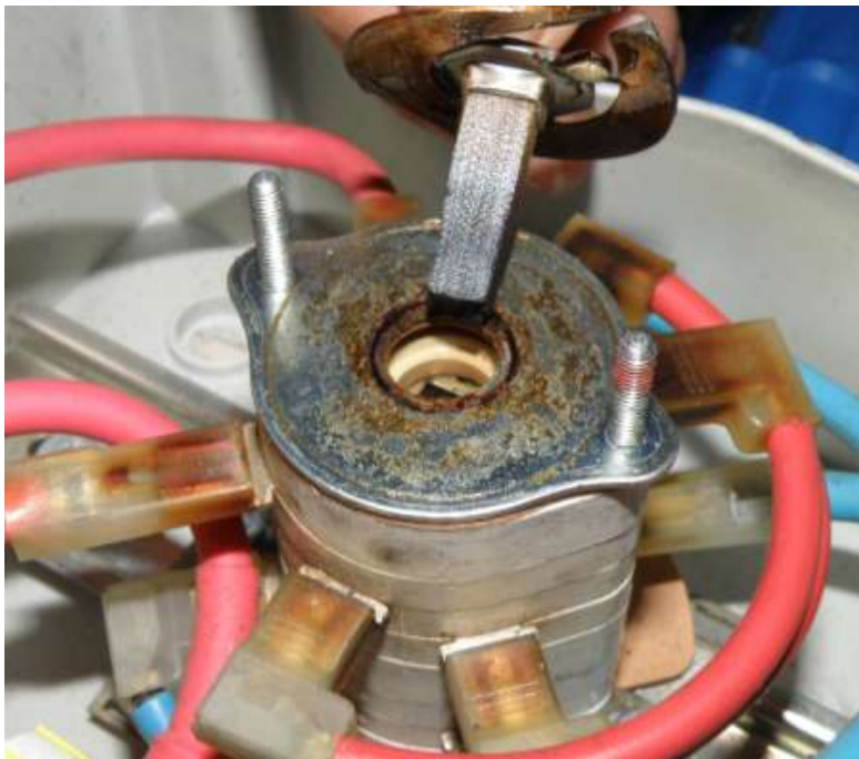
Bild 3-24: Deutliche Überhitzungsspuren an Anschlüssen und im Inneren eines „überlebenden“ Schalters
