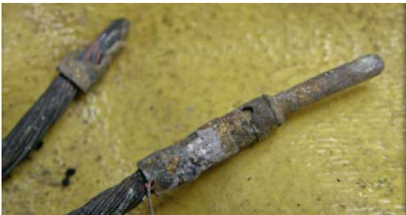
Bild 3-21: Reste zweier Steckverbinder aus dem Schutt eines Wohnhauses., [9] (Foto: Institut für Schadenverhütung und Schadenforschung (IFS))
