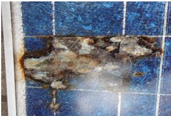
Bild 3-46: Direkter Blitzschaden an einer 10 Jahre alten Anlage (Quelle: Photovoltaik-Büro Temus&Diehl GBR)
