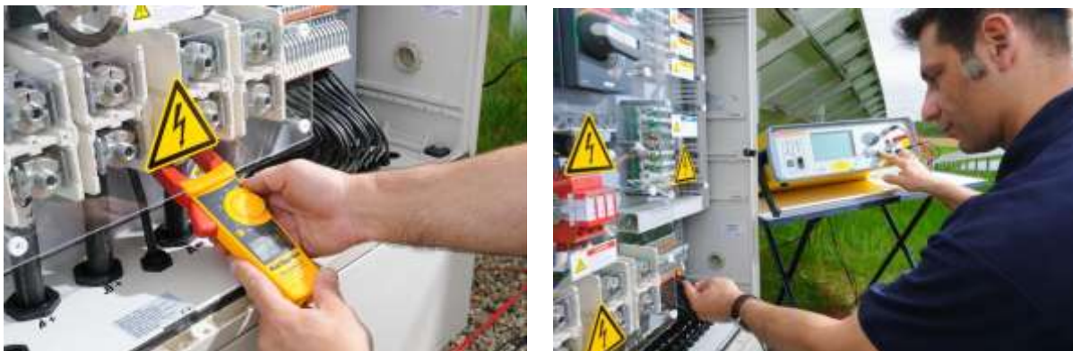
Bild 5-33: Strangmessungen am Generatoranschlusskasten
