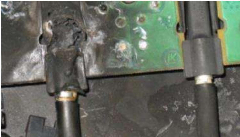
Bild 3-27: Beschädigte Steckkontakte in einer Modulanschlussdose
