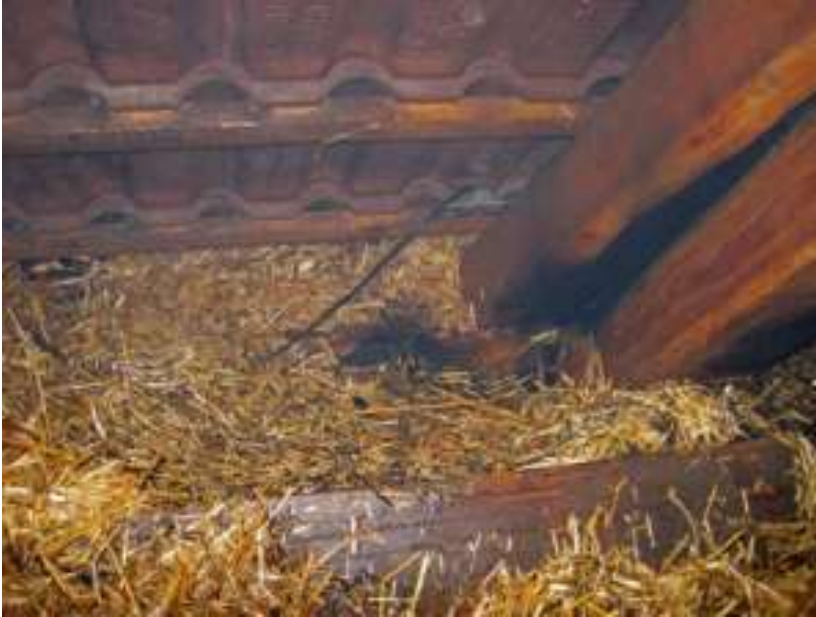
Bild 3-33: Glimpflich verlaufener Brandfall (Foto: Feuerwehr Ellwangen)
