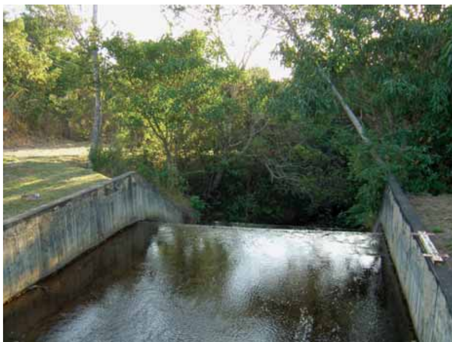
Captação do Córrego Brejinho. Foto: Carlos Terrana.
