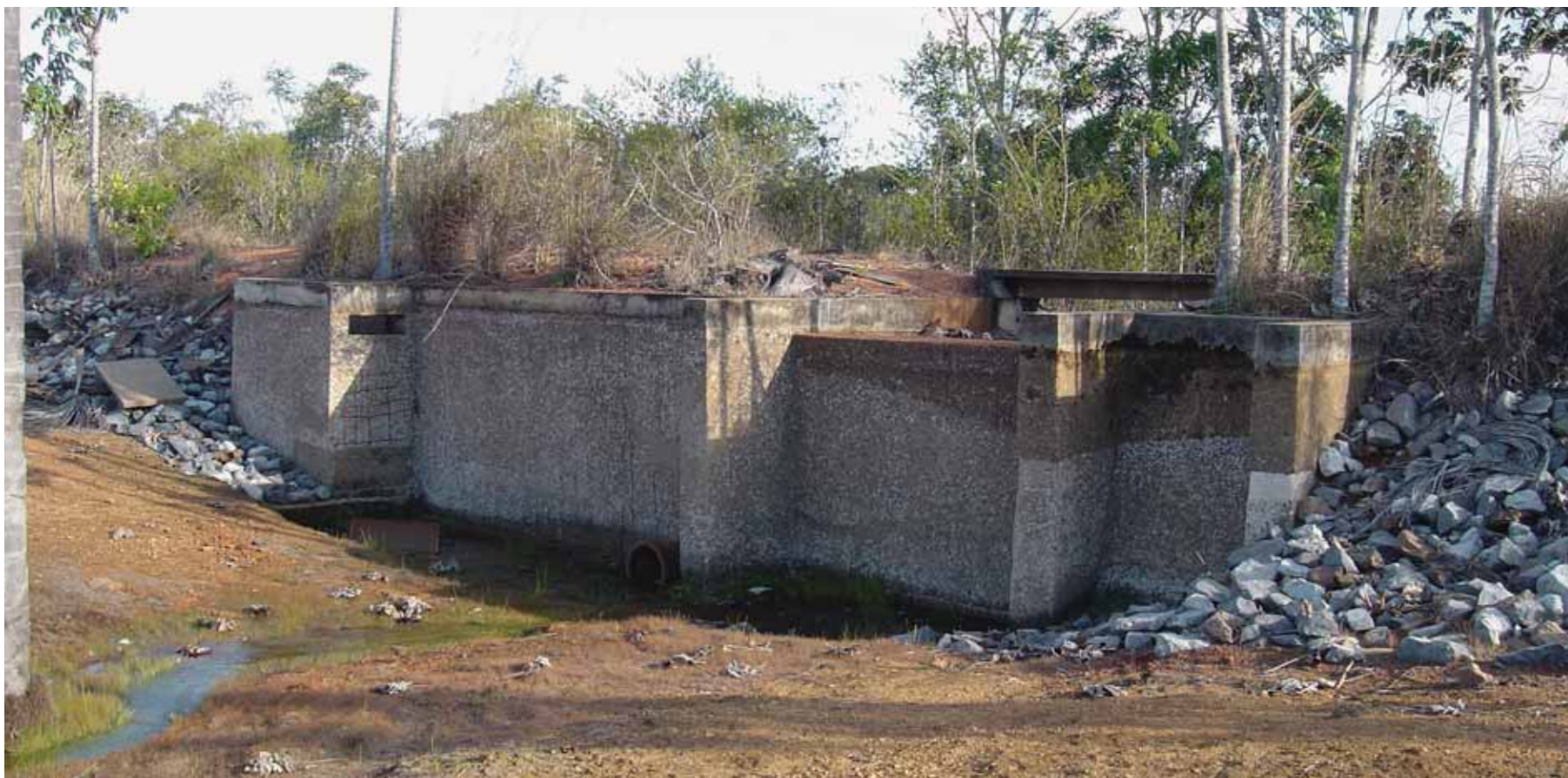
Captação do Córrego Cascarra (desativada). Foto: Carlos Terrana.
