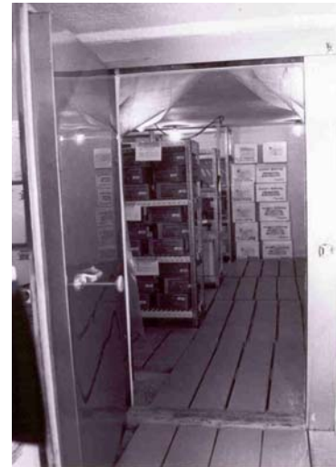
Foto 48 Vista interna de la cámara fría.
