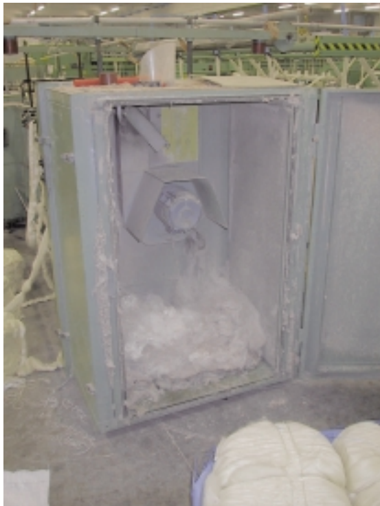
Figura 19 – Portello di accesso alla camera di raccolta dei cascami
