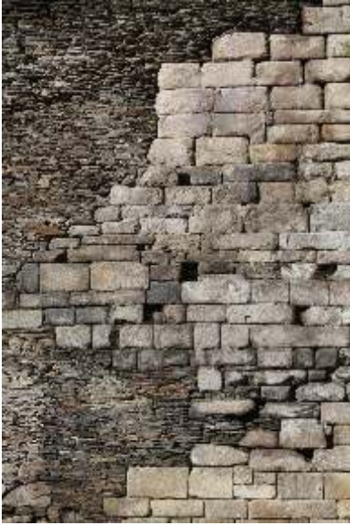
Trabajo de cantería donde se intercalan los materiales metamórficos y los ígneos en la Muralla.
