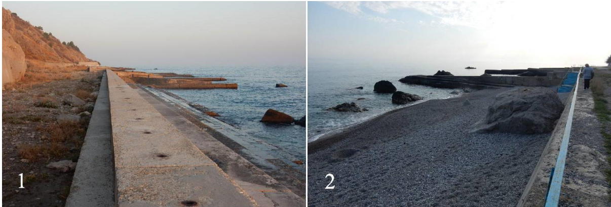
Рис. 3. Полуразрушенные берегоукрепительные сооружения мысового участка берега в районе Понизовки: 1-с полностью вымытым материалом искусственных пляжей, 2 – с частично сохранившимся пляжем
