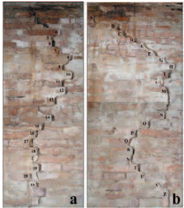
Fig. 5 - Mappatura delle fessure sulla parete destra (a) e sinistra (b) della sezione 3 del corridoio.
