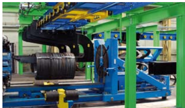
Deutsche Edelstahlwerke: Coil finishing line in Hagen
