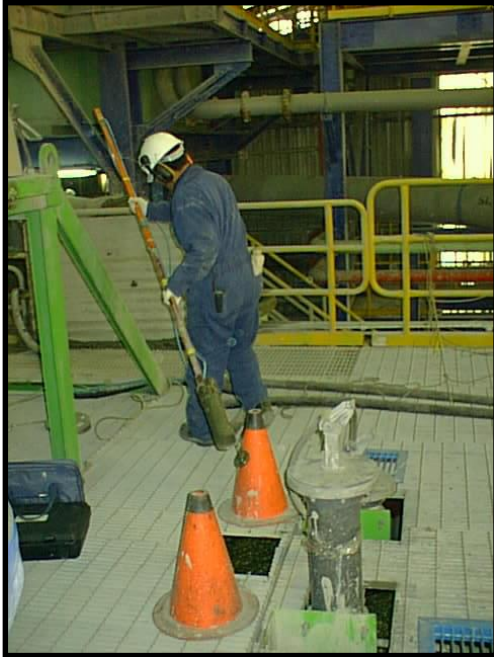
Inyección de Trazador Radiactivo
