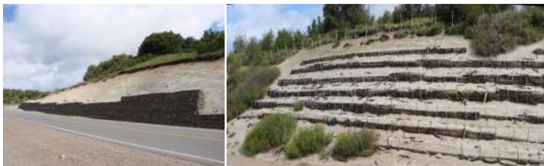
Figura 7.20: Estabilización de laderas con gaviones en la base del talud. Se utilizan troncos en líneas transversales a la pendiente sostenidos por postes enterrados. Entre las hileras de troncos se hace la plantación de vegetales herbáceos y arbustivos. (Aluminé, Neuquén, SECYOT-UNRC).
