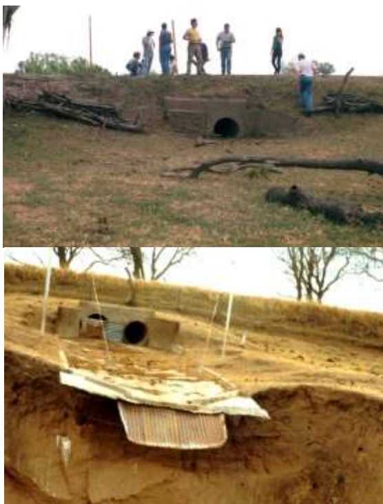
a. Regulador de escurrimiento, con vertedero principal en la base (Cuatro Vientos, Dpto. Río Cuarto, Córdoba).
