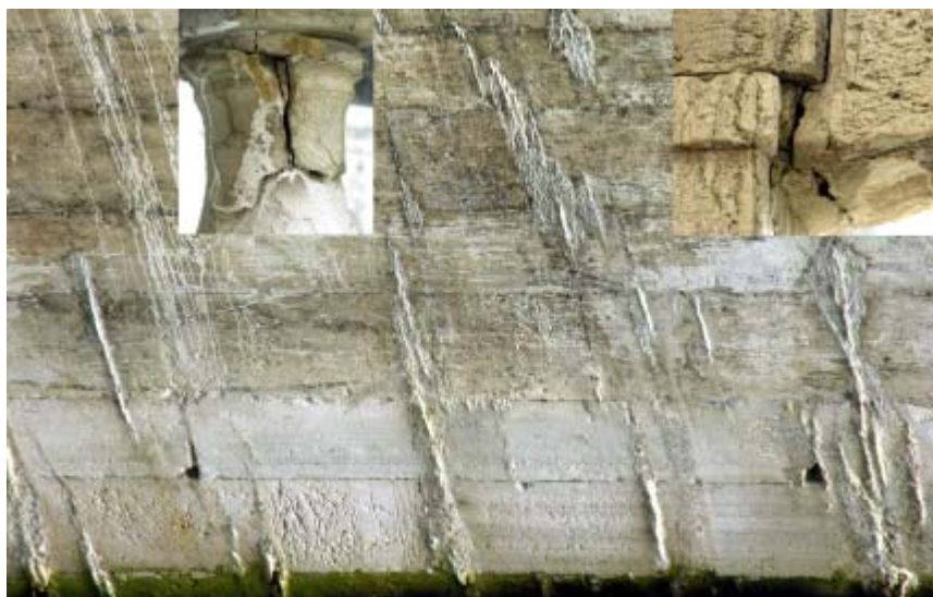
L'importanza delle concrezioni gessose che si sono venute a formare sotto l'arcata del Ponte di Rialto nei pochi anni trascorsi dall'ultima radicale pulitura, denuncia come siano in atto infiltrazioni disgregative all'interno della struttura portante. Nei riquadri vediamo esempi dello stato delle pietre sul lato superiore del ponte
