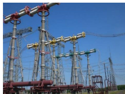
750-kV-Leistungsschalter, UW Albertirsa (H)
