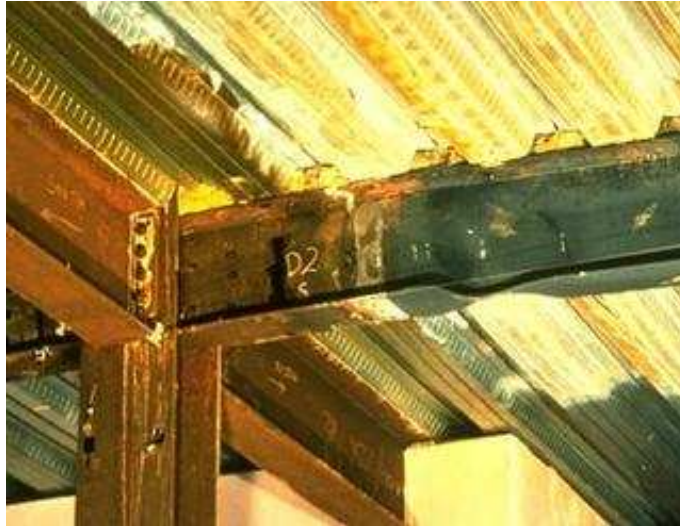
Figura 1: Pandeo local en ala inferior de viga.
