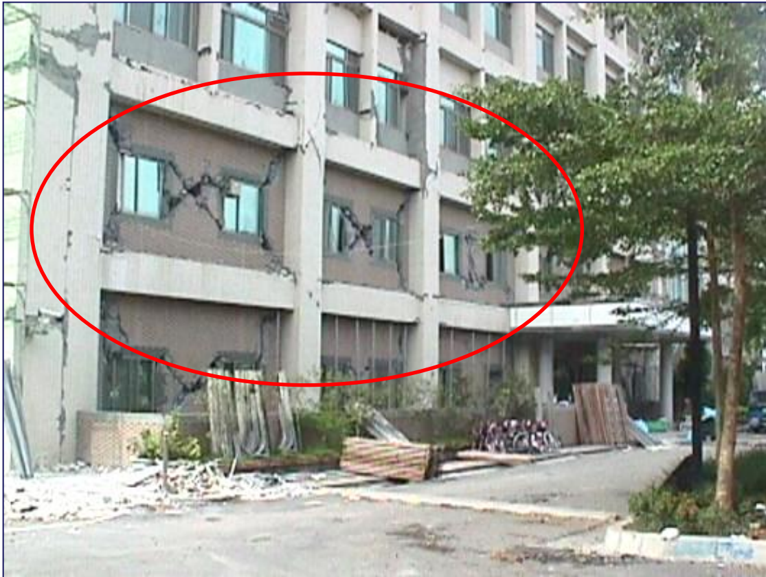
Fracturas conjugadas y fenómenos de cizalla pura en edificios Terremoto de Taiwan, 1999
