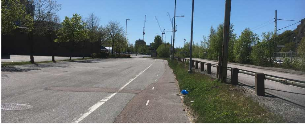
Figur 18. Gångbana saknas och cykelbanan är endast avskild med vägmarkering på del av Lundby Hamngata.
