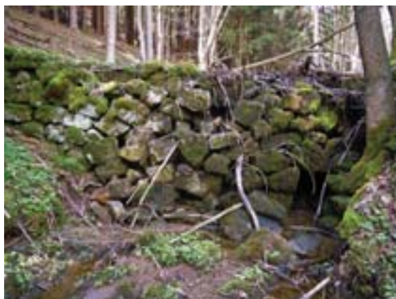
Fot. 4. Tama przeciwpowodziowa i prze- ciwrumowiskowa na Złotnowskim Potoku w Januszowie (fot. A. Latocha).
