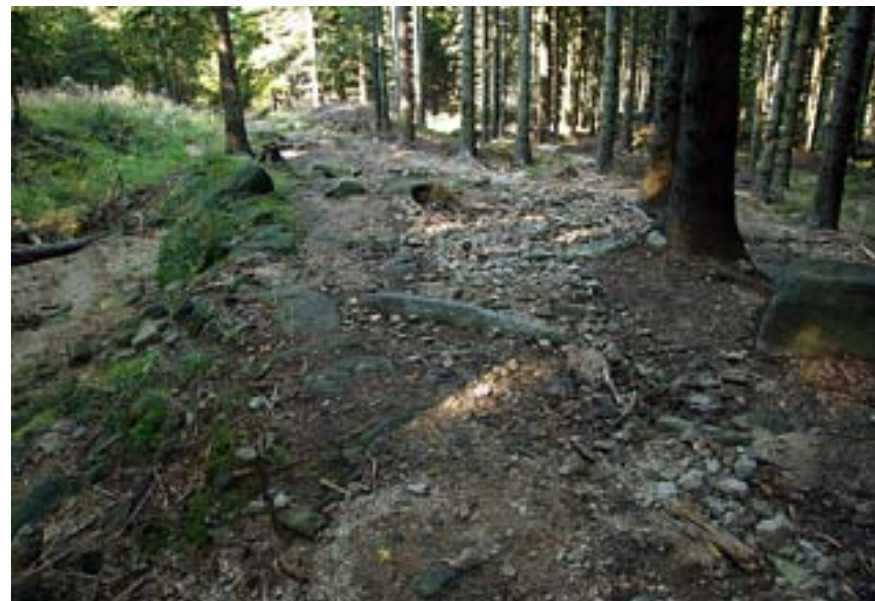
Fot. 2. Przesunięcie ruchu pieszego poza rozcięcia erozyjne wytworzone na powierzchni drogi (widoczne z lewej strony) powoduje wydeptanie runa leśnego, zmniejszenie infiltracji podłoża i splukiwanie materiału skalnego na rozległym fragmencie stoku (fot. M. Kasprzak).
