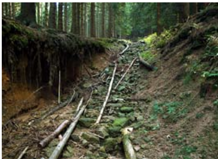
Fot. 4. Największa ze zmierzonych rynien erozyjnych powstała na mało uczęszczanym szlaku turystycznym w dolinie Jodłówki na pd. od Borowic. Jej dno pokrywa przemyty rumosz skalny i drzewny. W głębi zdjęcia odsłania się wypreparowana rura wodociągowa (fot. M. Kasprzak).
