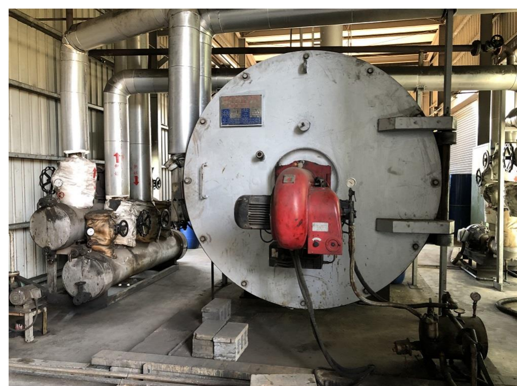
圖三、熱媒鍋爐
