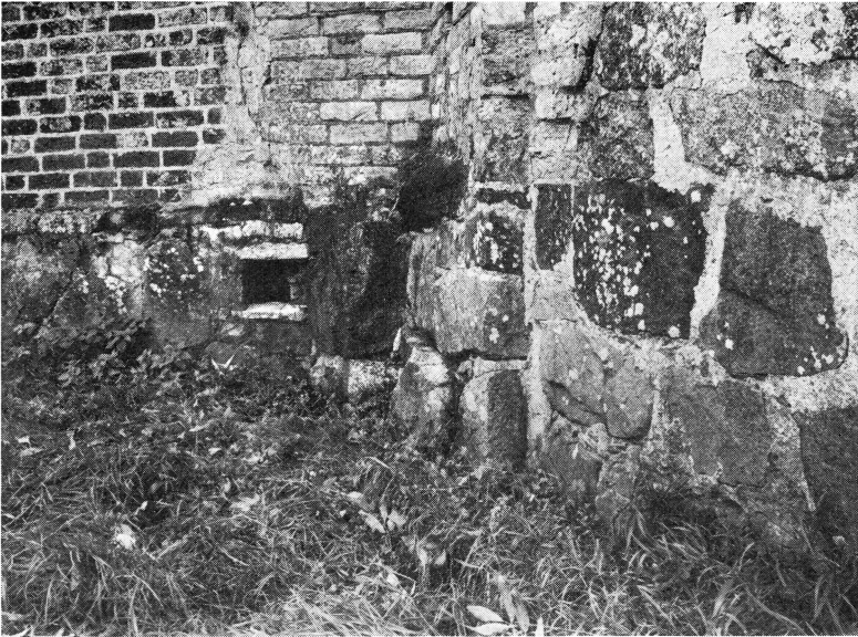
Bild 2. Rester av grunden till det gamla koret. Den snedställda strävpelaren står på en med sakristians östvägg parallell grundmur.
