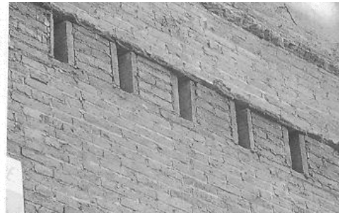
La preparación de los apoyos de las vigas, de manera que su cabeza no quede empotrada en la pared y permita la circulación del aire en todo el perímetro, resulta una buena medida para evitar su degradación, si bien, representa una disminución importante en la traba horizontal del edificio.
