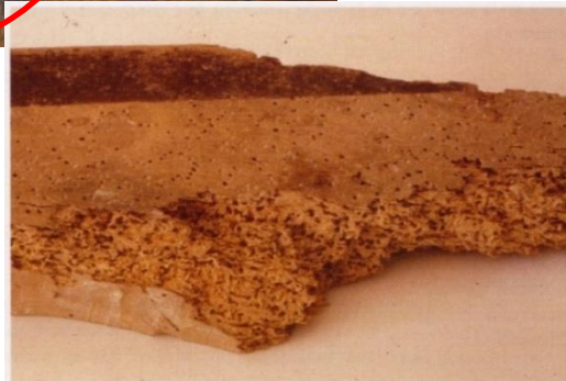
Figura 1.2 Daños producidos por anòbidos.
