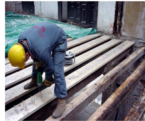
Colocación de tablero sobre vigas o elementos laminares sobre las vigas para formar una sección en T
