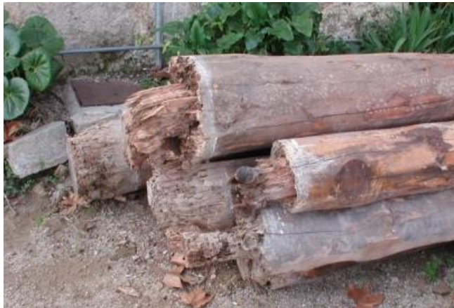
Pérdida de sección en cabezas de vigueta
