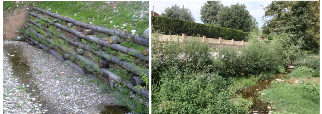
Foto de finalización de las obras y tras 1 año de la intervención
