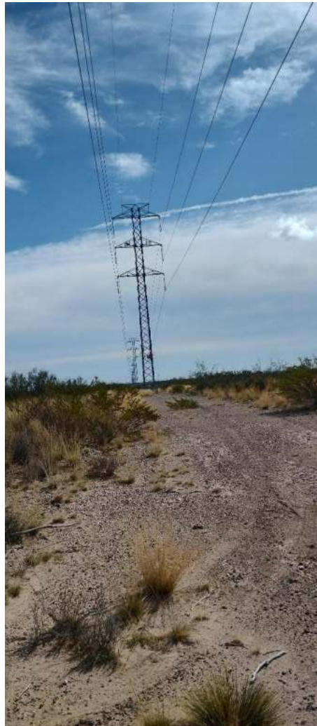
Fotografías 49 y 50. Líneas eléctrcas San José 132 kV y 500 kV
