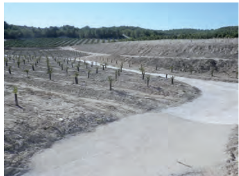
Impermeabilización y transformación del río Nacimiento, tras haber cubierto con hormigón el cauce.
