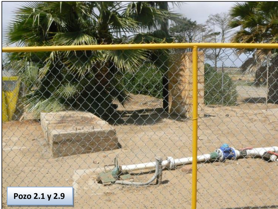
Foto 14. Vista de las instalaciones de los pozos # 2.1 y 2.9 (ambos comparten la misma tubería) y suministrarán agua salobre a la planta desaladora.
