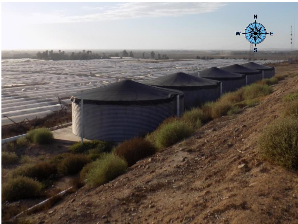
Foto 4. Tanques de metal para el almacenamiento de agua de pozo con capacidad de 100 m 3 cada uno.
