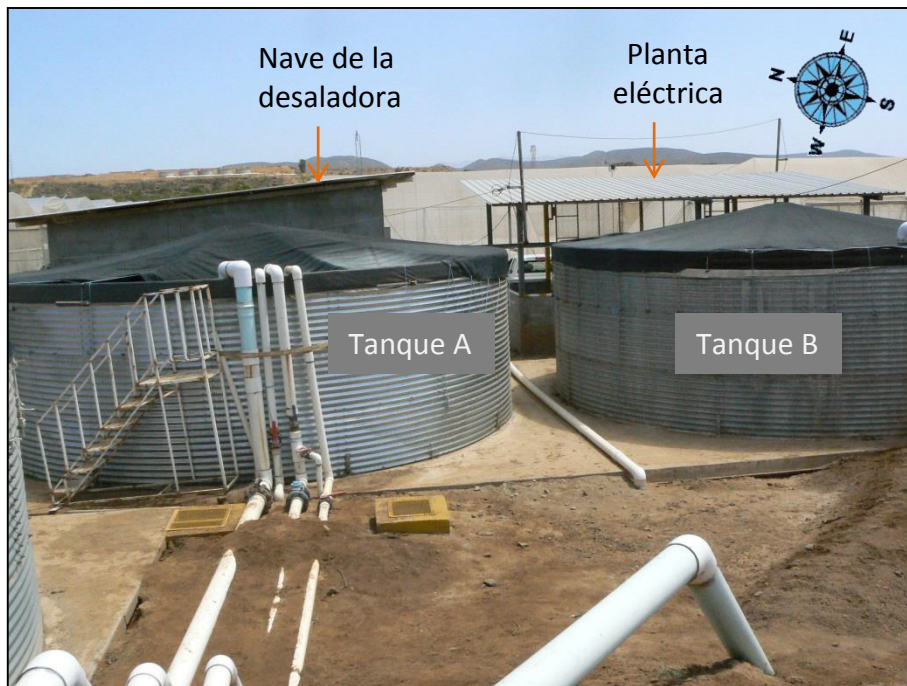
Foto 10. Tanques de almacenamiento del agua de pozos que alimentan la planta desaladora. En el tanque B, se recibe el agua del Pozo #1; en el tanque A se mezcla el agua de rechazo de los módulos 2 y 3 y la salobre extraída del resto de los pozos.
