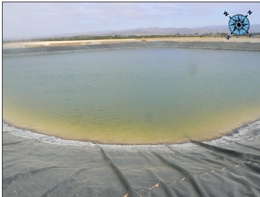
Foto 12. Vista de un estanque para almacenamiento temporal del agua de rechazo. Desde este sitio se rebompeará hacia el punto de descarga.
