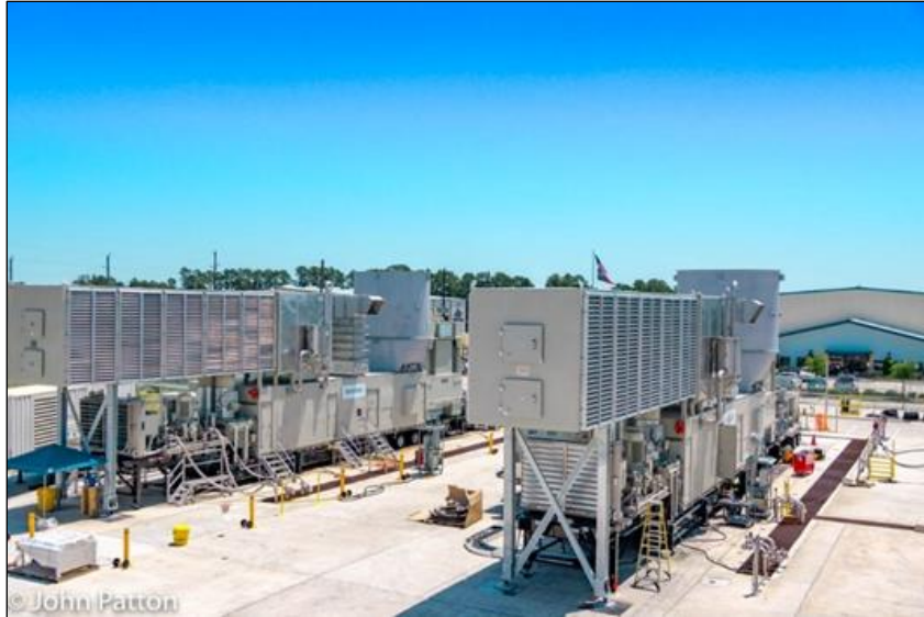
Foto II.2.4.2-4. Ejemplo de la instalación de unidades aeroderivadas (imagen de archivo)
