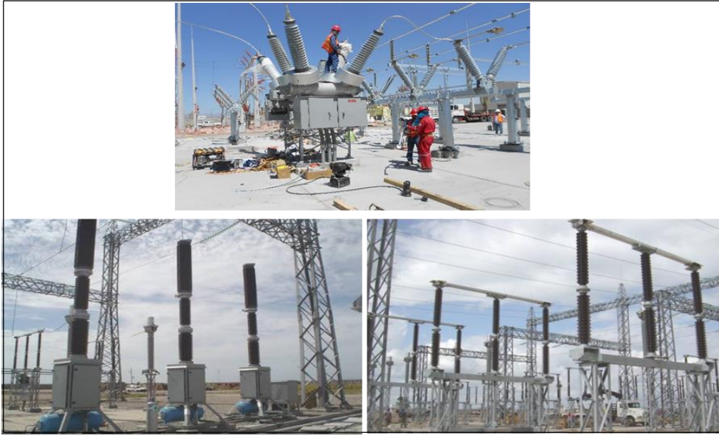
Foto II.2.4.2-6. Ejemplo de interruptores de potencia (arriba e izquierda) y cuchillas de potencia (derecha)-imagen de archivo-
