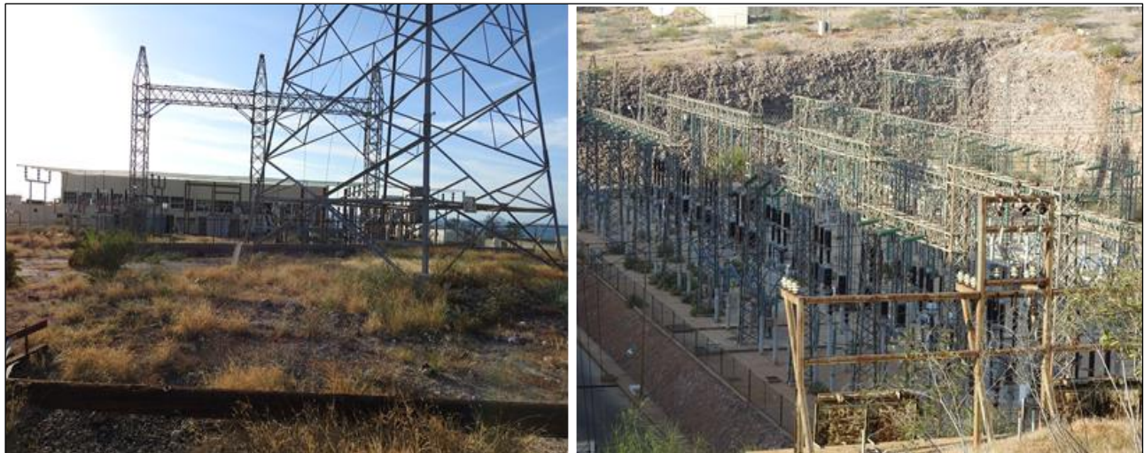
Foto II.2.4.2-5. Vista general de las subestaciones eléctricas PUI (izquierda) y PUP (derecha)
