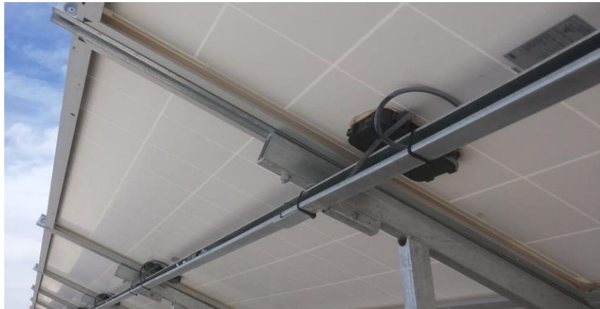
Fig. 9. Cableado de panel
