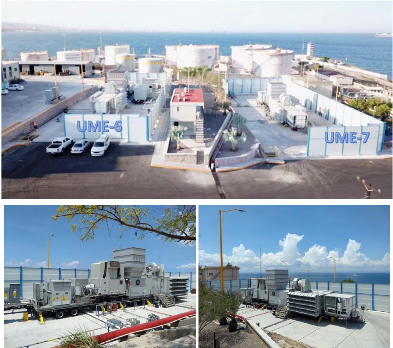
Figura II.2.1.413. Vista de las dos UMEs de la CT Punta Prieta
