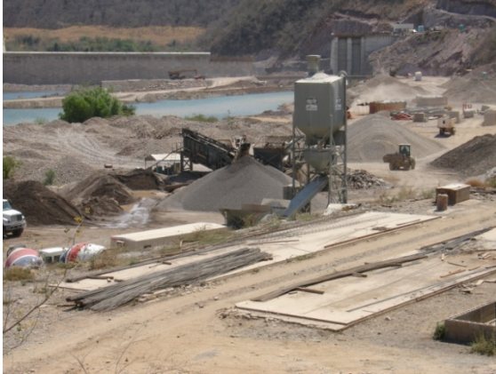
Planta de concreto
