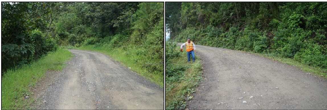
Figura I.4 Condiciones actuales de la carretera existente.
