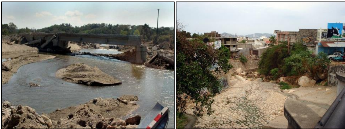
Figura IV.64 Daños causados por el huracán Stan en el año de 2005.
