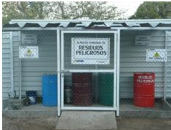
Figura 3. Ejemplo de almacén de residuos peligrosos y de manejo especial con base de concreto.
