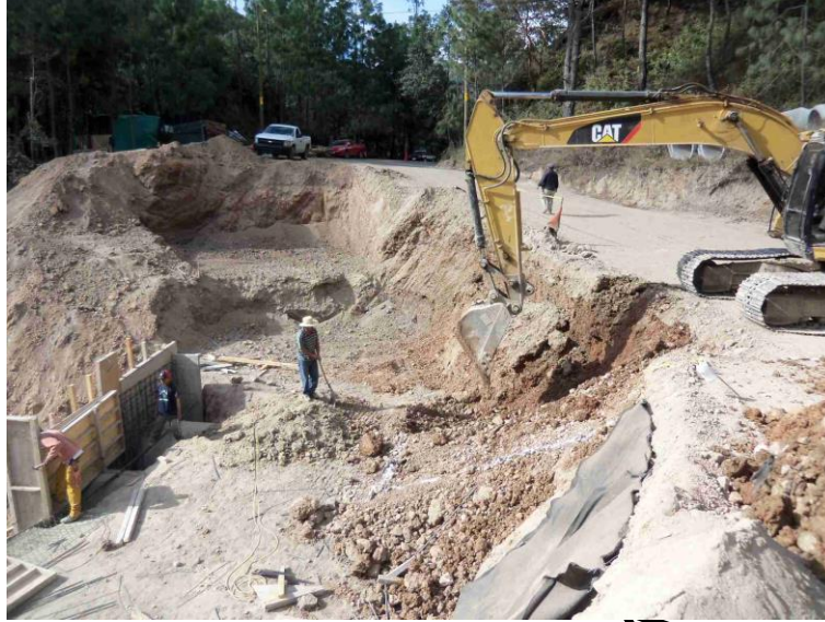
Foto II. 7 Ejemplo de corte, carga y retiro de material producto de la excavación.
