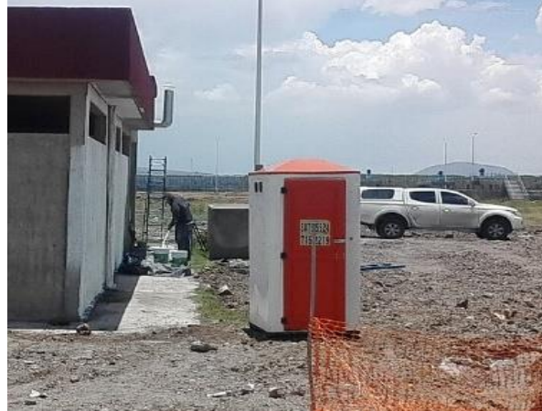
Foto II. 50 Ejemplo de Instalación de Sanitarios Portátiles.
