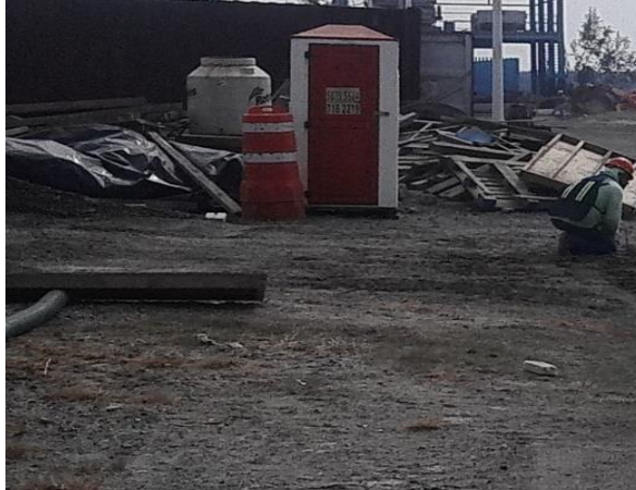
Foto II. 49 Ejemplo de Instalación de Sanitarios Portátiles.
