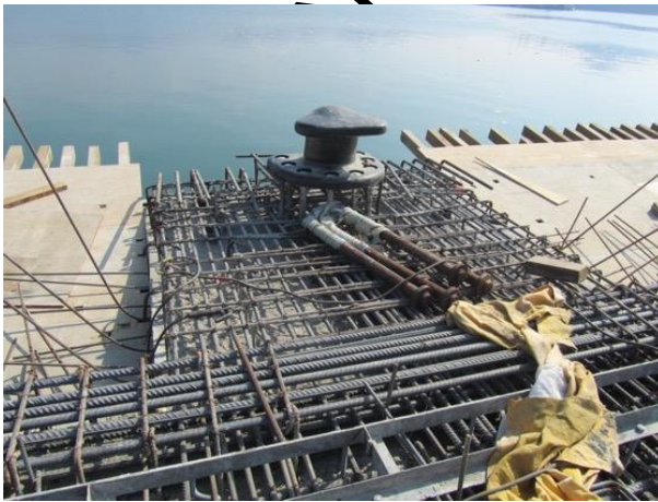
Foto II. 42 Ejemplo de instalación de defensas y bolardos en el muelle. FUENTE: CONTECON MANZANILLO, S.A. DE C.V.
