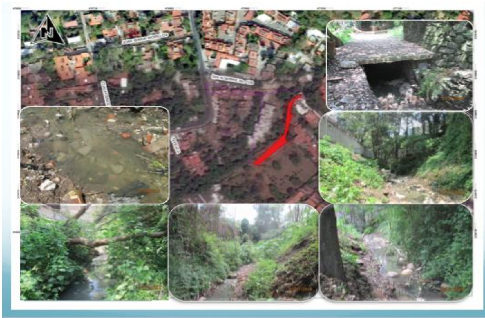
FIGURA II-4 FOTOGRAFÍAS SE ILUSTRAN LA CONDICIÓN DE LA ZONA DE BARRANCA EL ROSAL EN EL SEGMENTO DE 109.5 M
